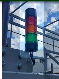
1 – Sinalizador luminoso e sonoro
